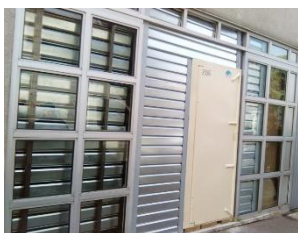
Protection d'un local commercial
